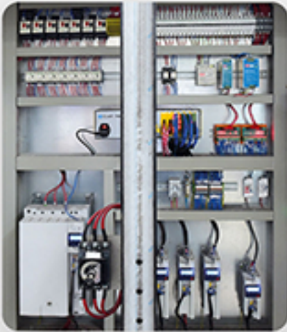
ELEKTRİK PANOSU ELECTRICAL PANEL
